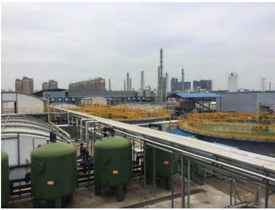
公司内部污水处理站
