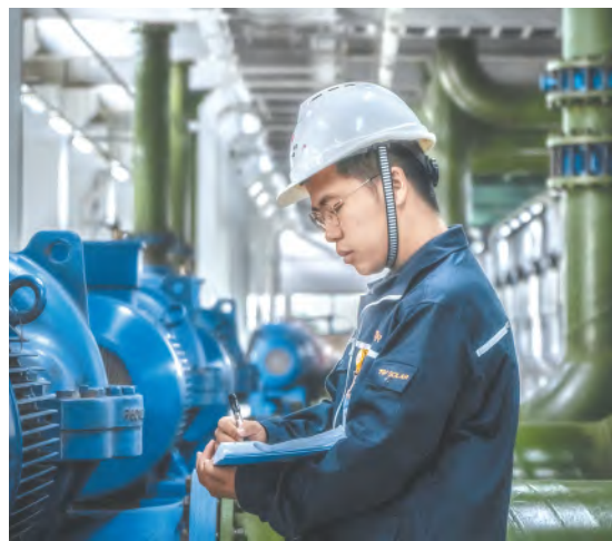
巡检中发现电机异响,现场记录异常点位
