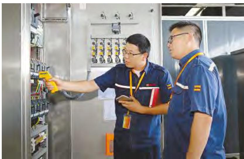
合肥公司检查小组对外围动力设施进行电路隐患排查
